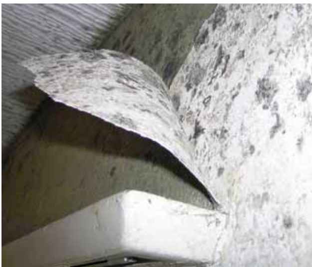
Bild 2: Schimmelpilzbefall auf der Tapete und dem darunterliegenden Verputz (Befall tiefer liegender Schichten).
