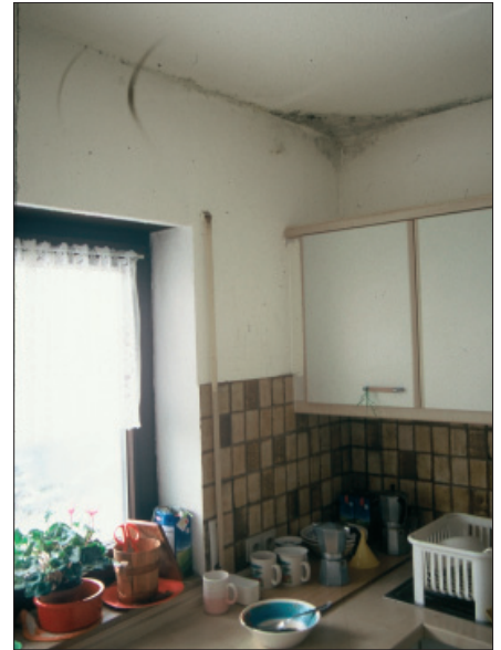
Typischer Befall in der oberen Raumecke: Die Betondecke stellt immer eine Wärmebrücke dar. Wenn wie hier mangels Lüftung weit überhöhte Raumluftfeuchte herrscht, kommt es zu diesem Schadensbild. Das festgestellte Nutzerverhalten sollte umgehend angepasst werden.
