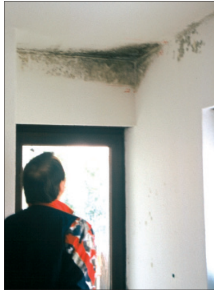
Der Schimmel befällt den Betonsturz über dem Rollladenkasten. Dessen Dämmung könnte vielleicht helfen, doch hier war die Nutzung schädlich: Die Wohnung wurde nachweislich nicht gelüftet, die Glasscheiben der Küche waren Stunden nach dem Kochen noch völlig nass.
